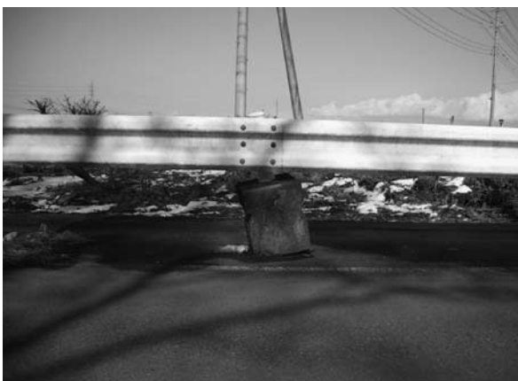
通学路に長期間設置されている危険な仮設ガードレール
