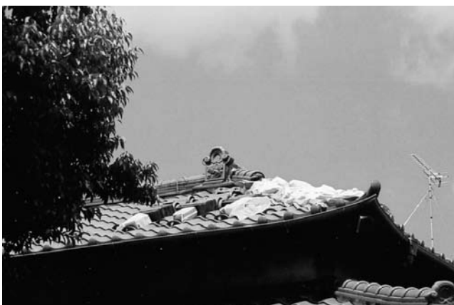
震度5で壊れた屋根瓦(松伏町内)
