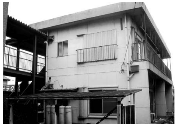
老朽化し危険性がある旧職員住宅
