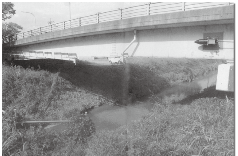
排水機能が低下している八間堀悪水路弥生橋下
