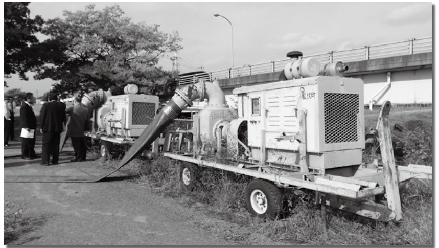
1台が機能しなくなった八間堀流末ポンプ機
