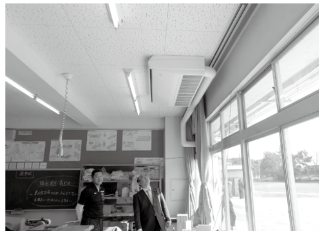
設置されたエアコン（野田市立福田中学校）
