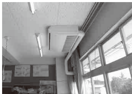
視察先のエアコン設置(天井吊形)
